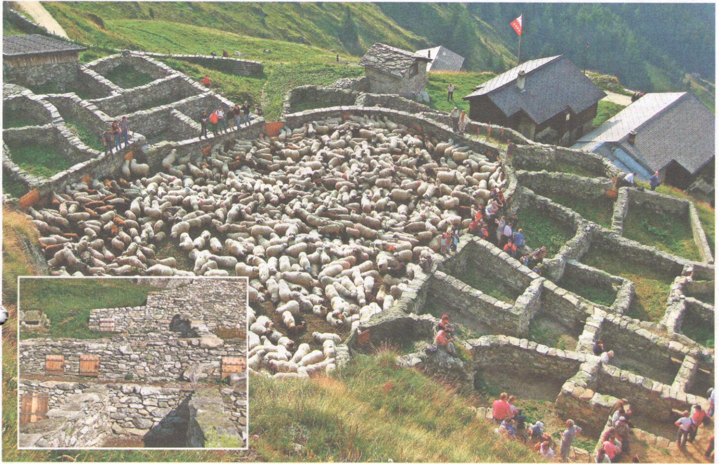
Traditionelle Vihscheide auf der Belalp im Wallis – die Sanierung der Haupt- und Seitenpferche dauerte sechs Monate.
